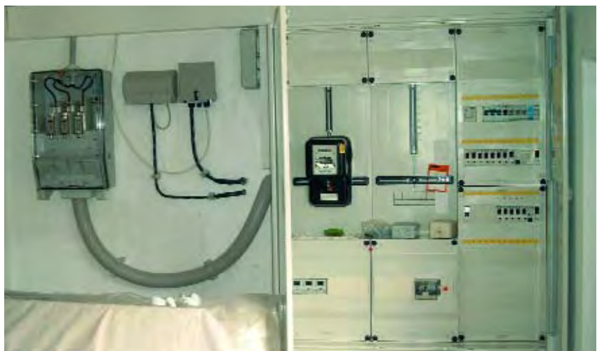
Bild 2: Hausanschlusskasten, Verteilertafel, Telekommunikationsverkabelung – alles neu, großzügig, sicher, redundant und zur Zufriedenheit der Kundin
