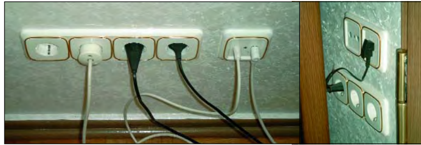
Bild 6: Ausreichend Stromanschlüsse, wo Fernseher und Telefon jetzt stehen (li.) sowie vorausschauend hinter der Schrankwand (re.)
