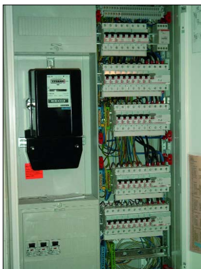
Bild 11: Üppig: Zählerplatz und Verteilung
